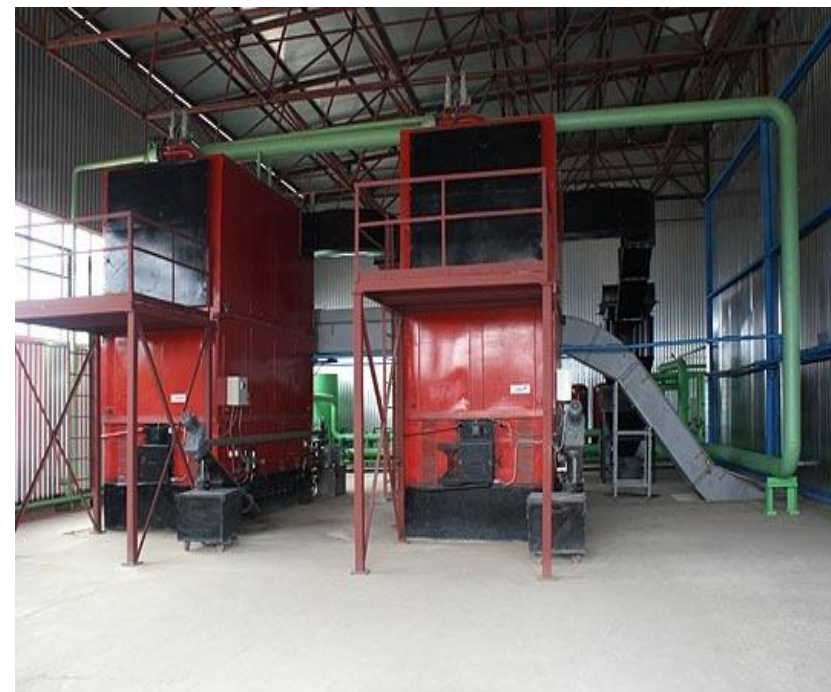
Котельная с 2-мя котлами ТК.0500 на пеллетах установленной мощностью 1 МВт
